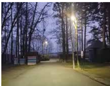
Energooszczędne oświetlenie uliczne
